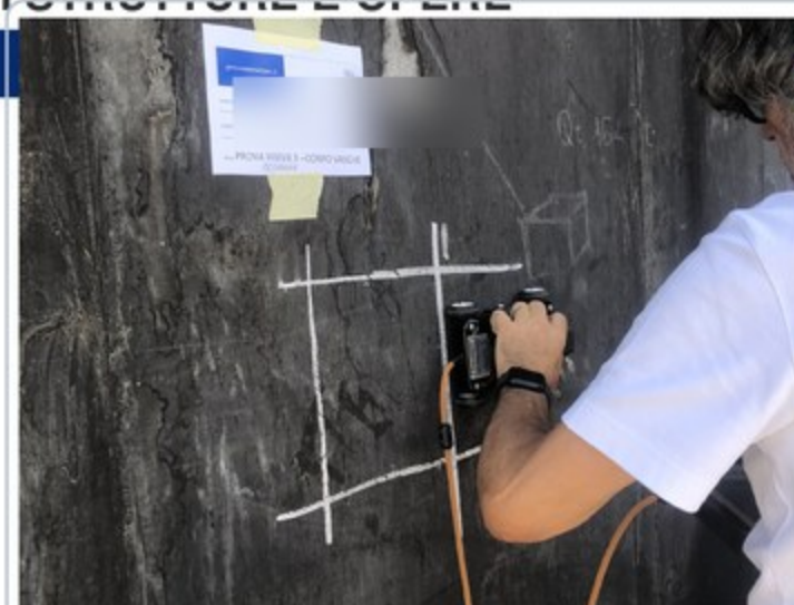
2. SCANSIONE SULLA SUPERFICIE IN C.A.
